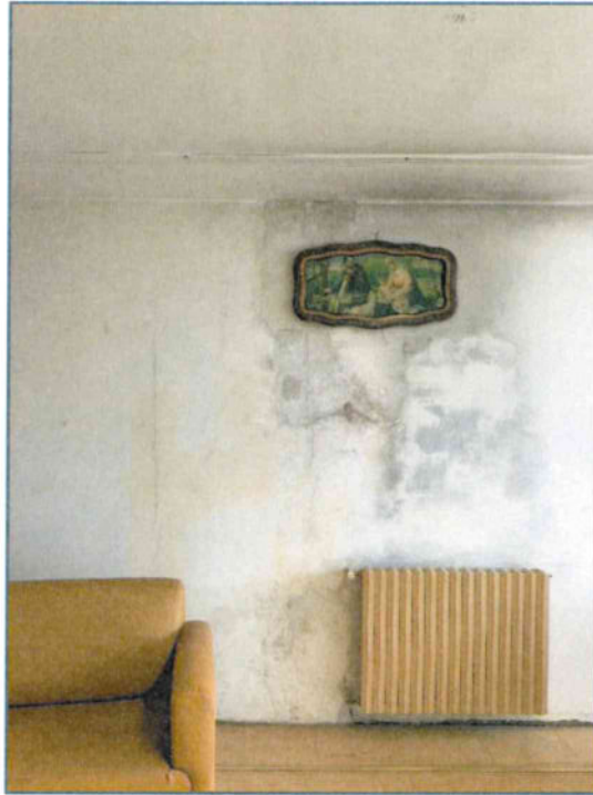
Foto 45. Piano quarto – Tra i Blocchi B e C: infiltrazioni all'interno del cavedio impianti
