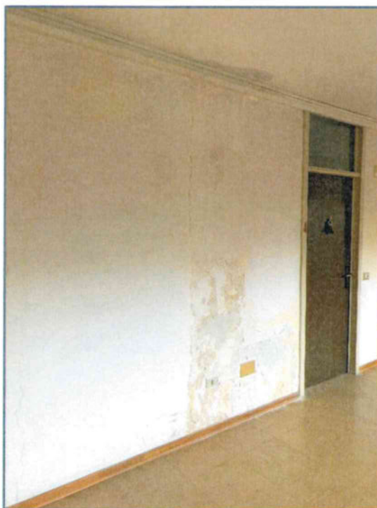
Foto 40. Piano primo – Blocco B: degrado sulla partizione verticale
