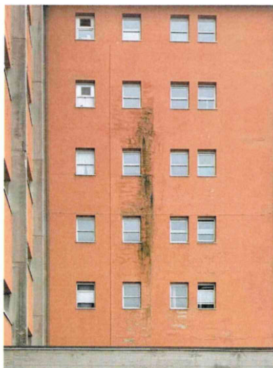
Foto 34. Vano scale tra i Blocchi A e B: Prospetto est: degrado dell'intonaco
