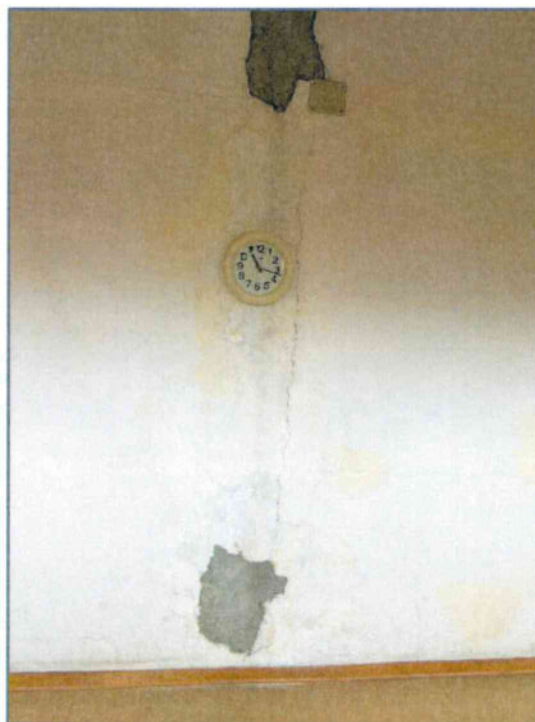
Foto 42. Piano primo – Blocco B: fenomeni fessurativi sulla partizione verticale
