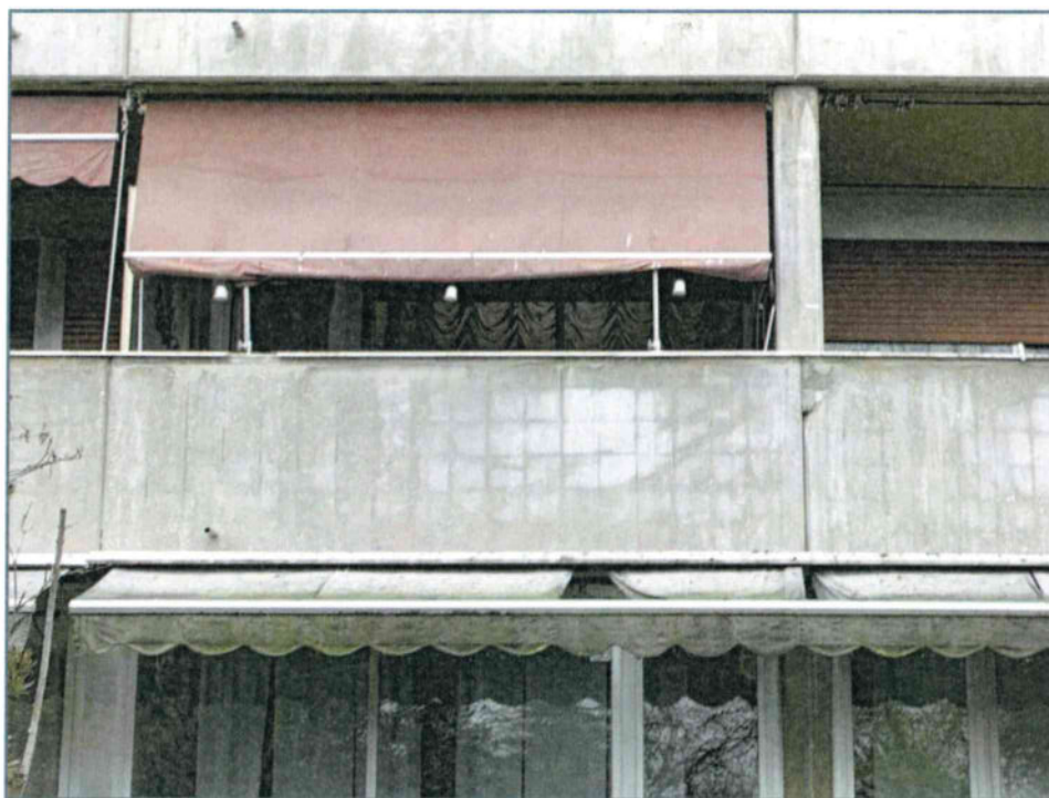
Foto 31. Blocco B - Prospetto sud: degrado del calcestruzzo armato
