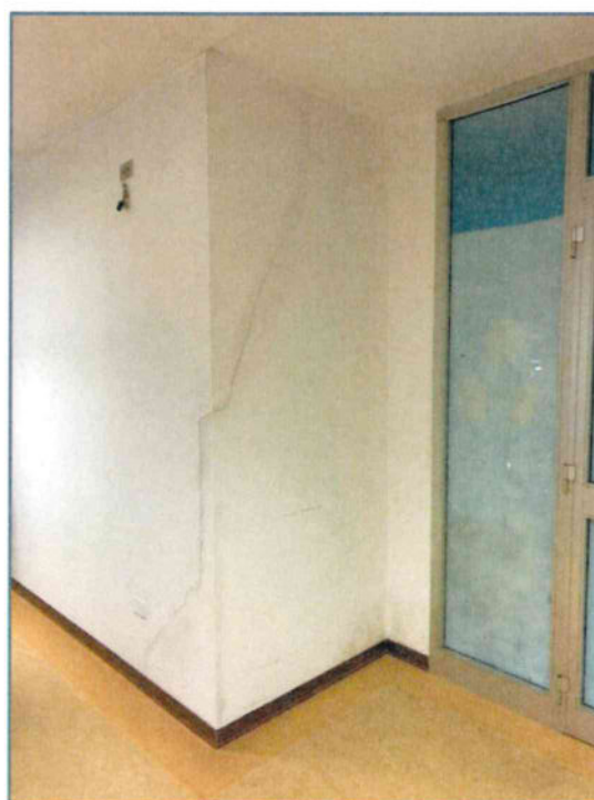
Foto 36. Piano terra -Blocco A: fenomeni fessurativi
