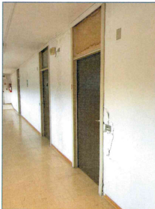
Foto 44. Piano quarto – Blocco A: fenomeni fessurativi
