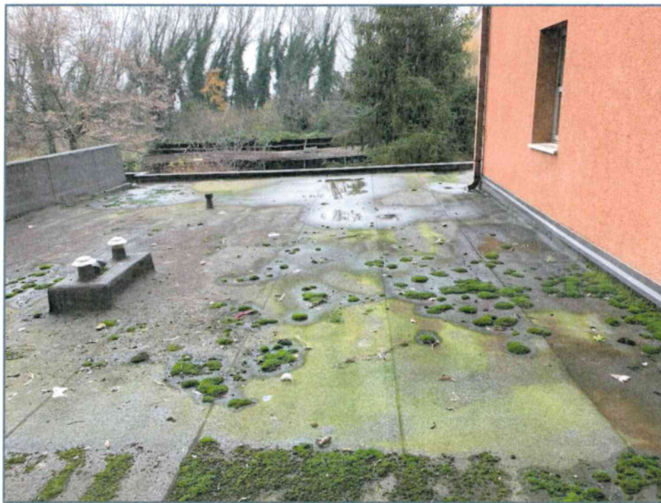
Foto 41. Copertura piano terra – Blocco B: formazioni di muschi sul manto
