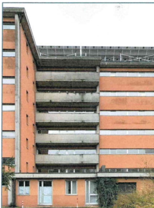
Foto 33. Blocchi B: Prospetto nord: degrado del calcestruzzo armato e dell'intonaco
