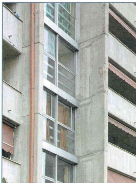
Foto 32. Blocchi B e C: Prospetto sud: degrado del calcestruzzo armato
