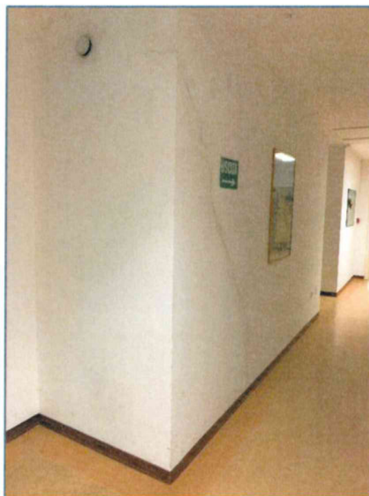
Foto 35. Piano terra -Blocco B: fenomeni fessurativi
