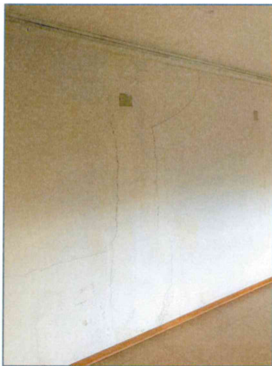
Foto 39. Piano primo - Blocco A: fenomeni fessurativi
