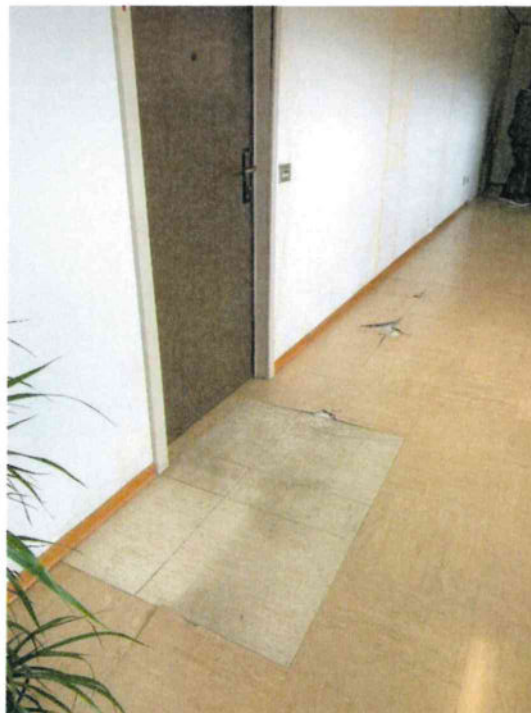
Foto 46. Piano quarto – Blocco B: degrado della pavimentazione in linoleum
