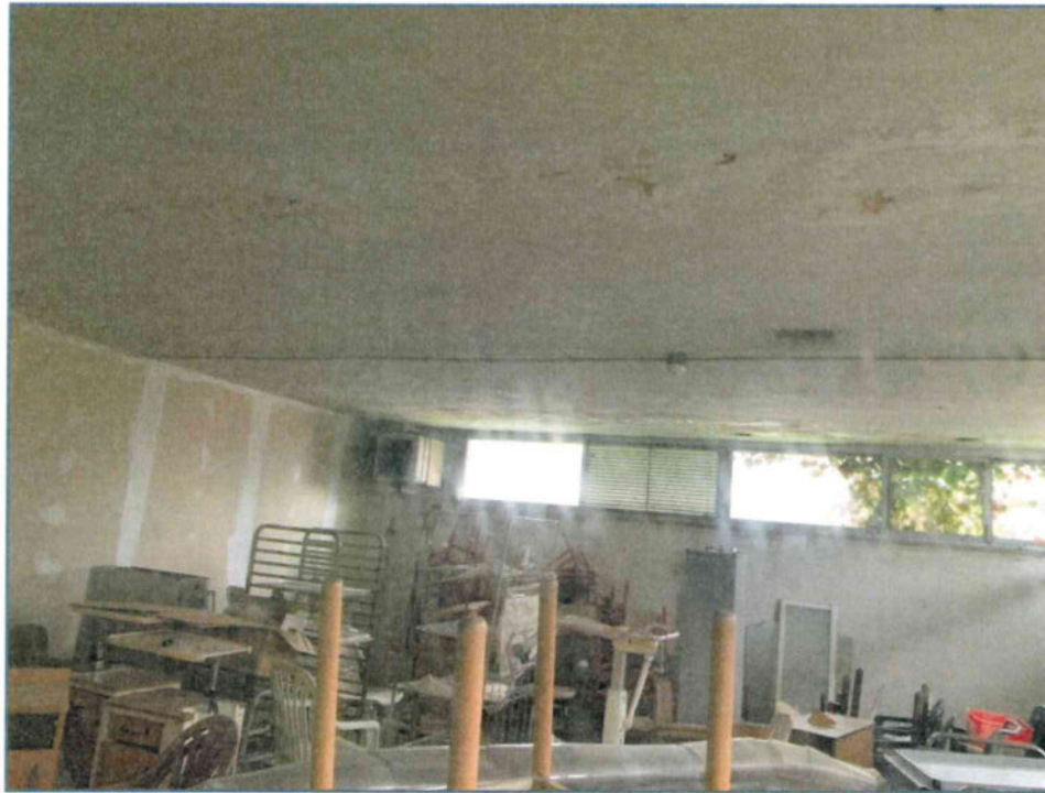
Foto 37. Piano terra -Blocco A: infiltrazioni diffuse dalla copertura
