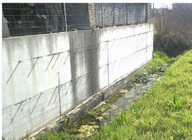
Figura 117 - Dettaglio del muro di confine costruito dentro il sedime dell'affossatura (Fonte: Piano delle Acque - Villadose)
