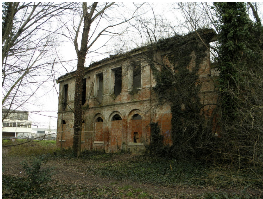
vista delle finestre tamponate al piano terra – inverno 2013
