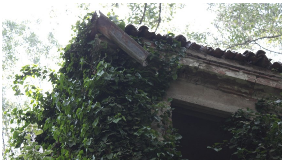
Vista della cornice della copertura con parte di canale di gronda in fase di crollo
