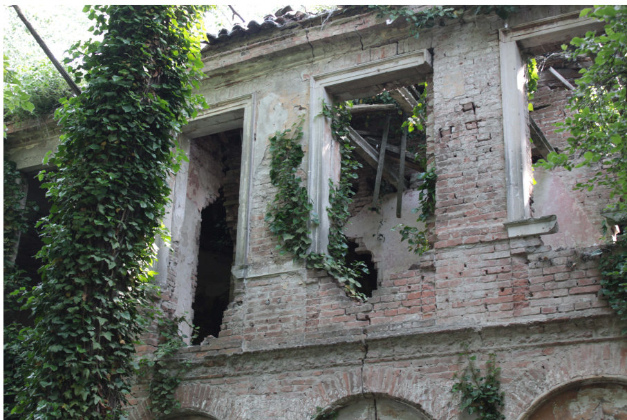
Vista delle cornici delle finestre del piano primo in fase di crollo
