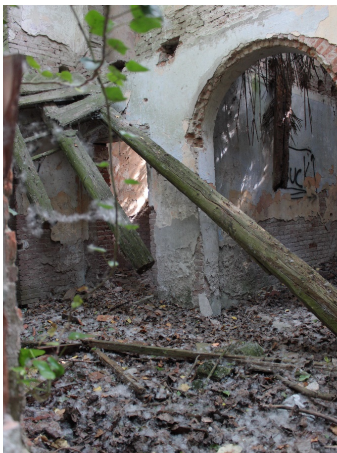
Particolare interno con parti del solaio crollato
